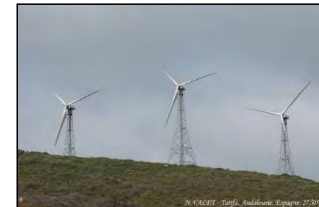
Photo 4 : Eoliennes de type « tour treillis » (Tarifa, Andalousie)
